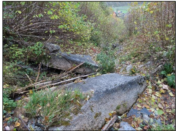
Bild 2: Kollabierte Betonsperre in der Speichenrunse (Engi).
