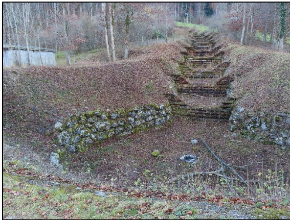
Bild 1: Holzsperrungen und Geschiebesammler in der Hofrunse (Glarus).
