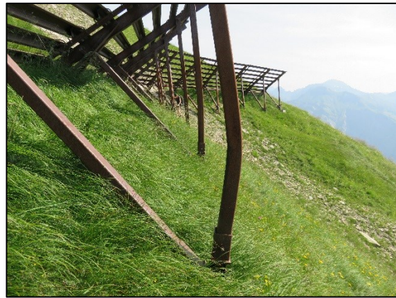
Bild 2: Eine von zahlreichen verbogenen Stützen in der LV Himmetzli.
